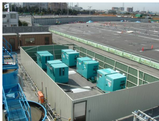
写真-4 送気設備
