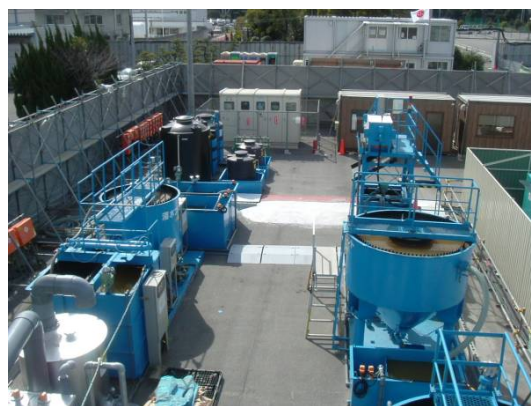
写真-6 水処理設備
