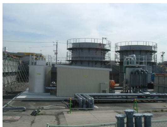
写真-5 吸気設備
