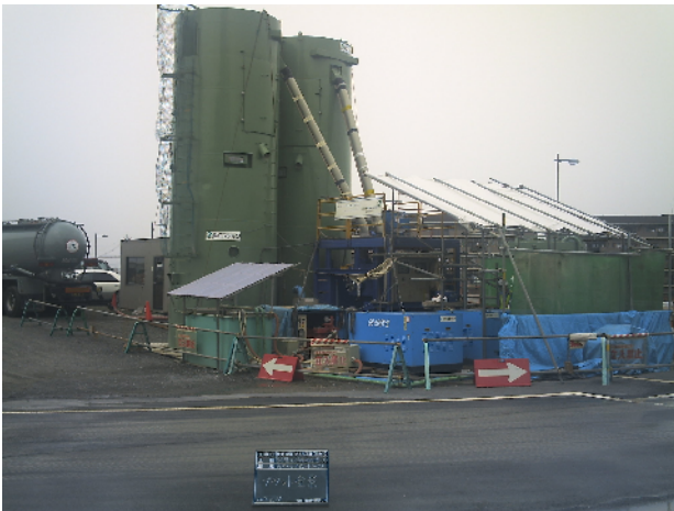
写真-2 流動化処理プラント
