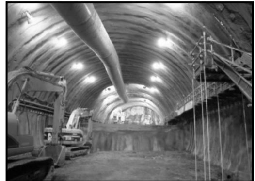
写真-4 坑内照度の確保
