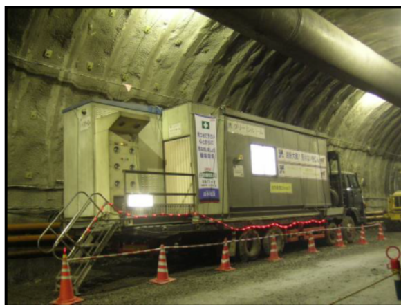
写真-6 クリーンルーム設置状況
