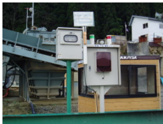
写真-4 出荷チェックポイントの受送信アンテナおよび操作盤
