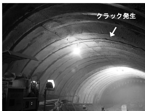
写真-1 輪切り状クラックの発生状況
