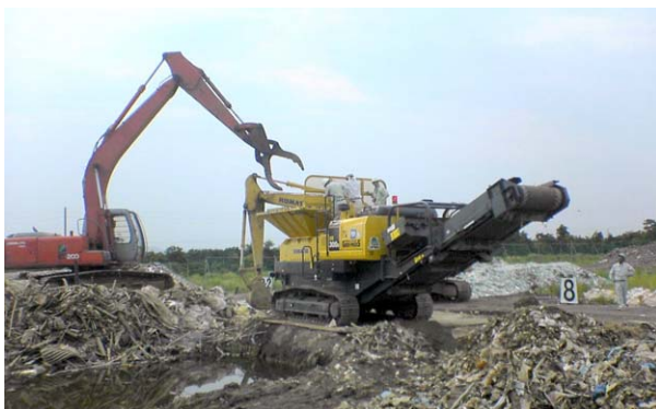
写真- 2 破碎機稼動状況（廃プラ）
