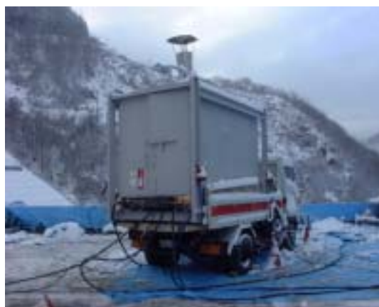
写真-3 移動式ボイラ（2002年度）
