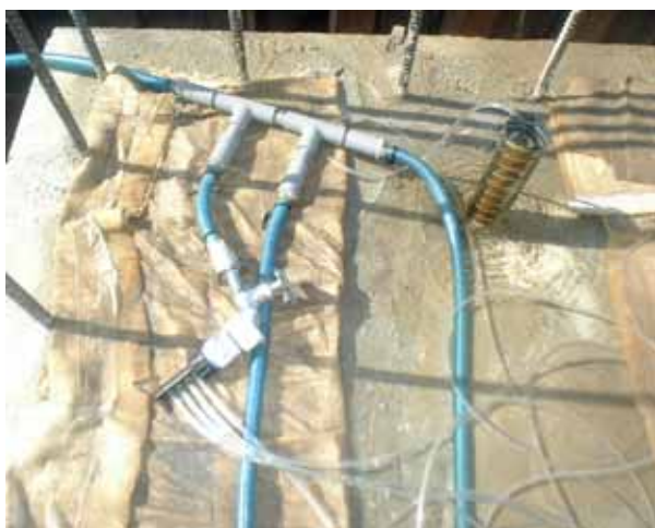
写真-3 クーリング用ビニールホース
