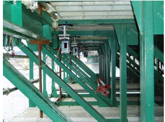
写真-6 受光センサー設置状況
