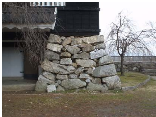
補修前：石材の抜け落ちが見られ間隙も多い
