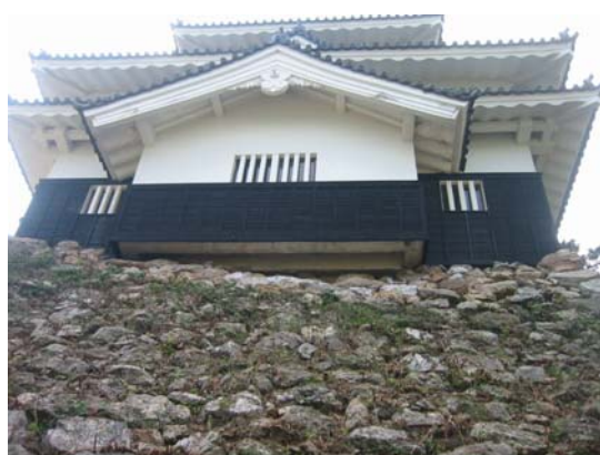
補修前：草本類が多く、櫓直下の石積みは不安定な状況にあるものも見られる
