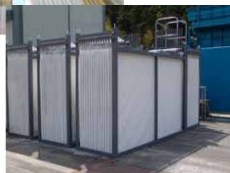
写真-9 処理装置
