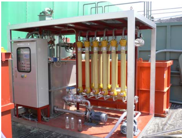
写真-2 処理システム
