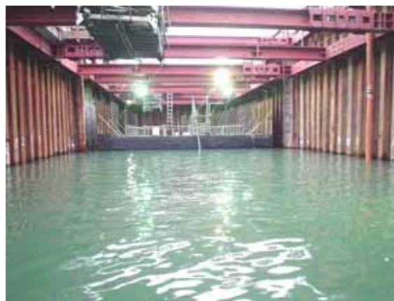
写真-1 躯体浮上状況
