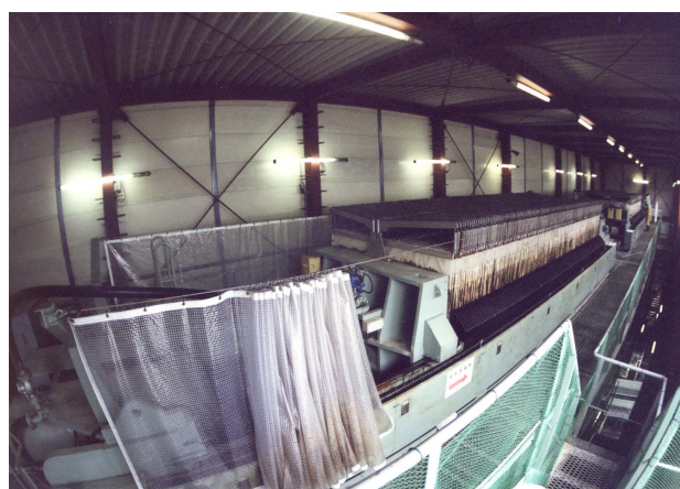
写真-7 高圧フィルタープレス
