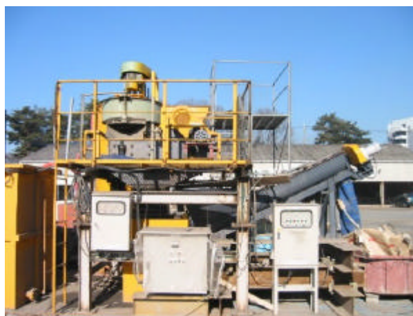
写真- 2 システム全景
