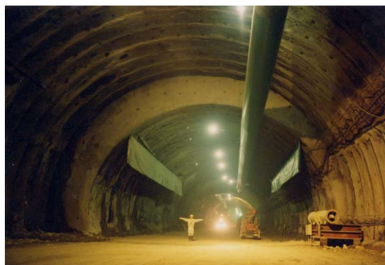
写真-3 集じん機坑全景
