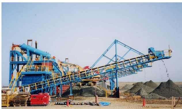
写真-4 計量ベルトコンベア (計量能力 4,000kN/hr)
