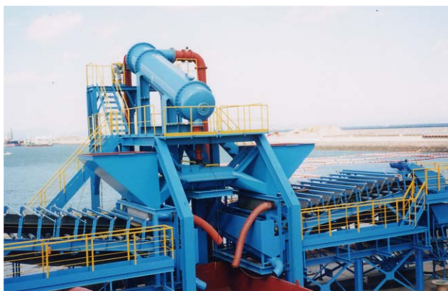
写真-3 脱水ベルトコンベア (搬送能力 200m³/hr)
