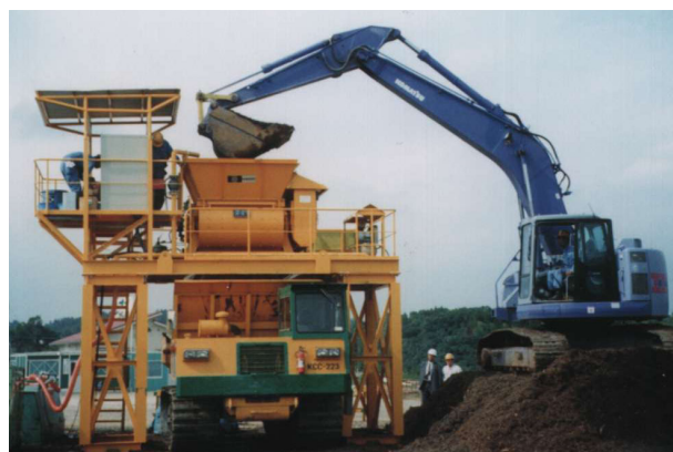
写真-1 生育基盤混合プラント
