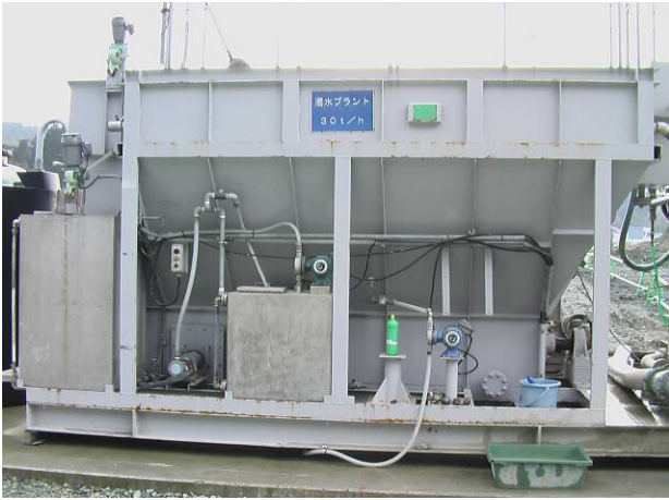
写真-5 汚水（濁水）の処理装置
