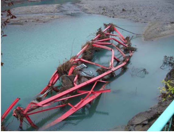
図-6 宮崎水害において支点ボルトが折損した新耐震設計指針前トラス橋 4)
