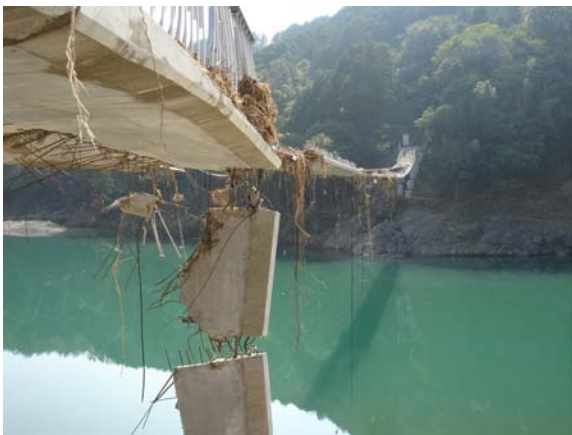
図-10 宮崎水害において損傷した吊り橋 5)
