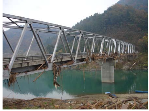
図-7 宮崎水害において桁に流水・流木が作用したが耐えた新トラス橋 4)
