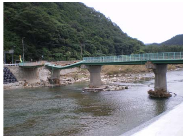
図-11 兵庫水害において変形した鋼製歩道橋桁 5), 9)
