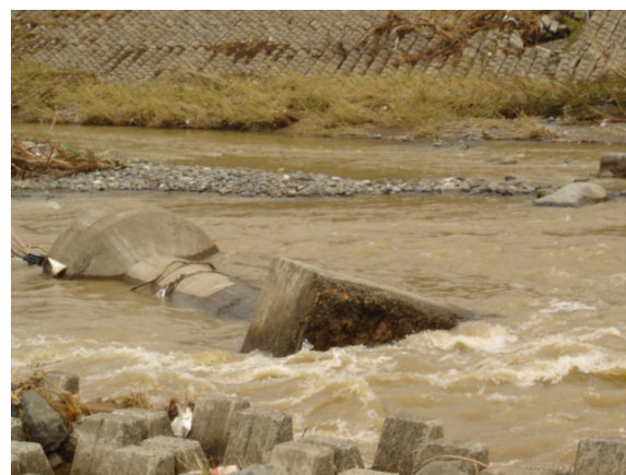
図-5 福井水害において岩着部が剥れた橋脚 1)
