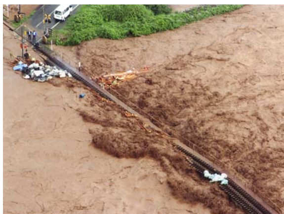
図-2 福井水害において洪水に水没する橋桁 1)
