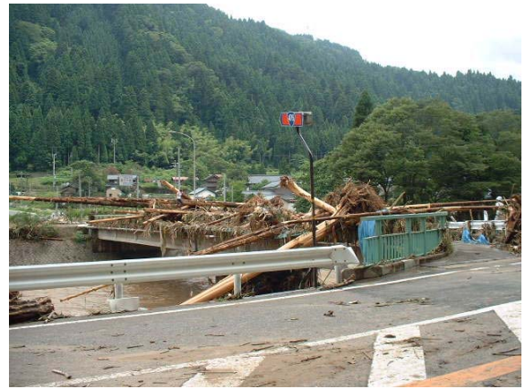
図-9 福井水害において流水・流木に耐えたコンクリート桁 8)
