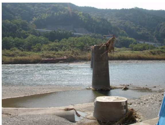
図-4 宮崎水害において打ち継ぎ目が割れた橋脚 3)
