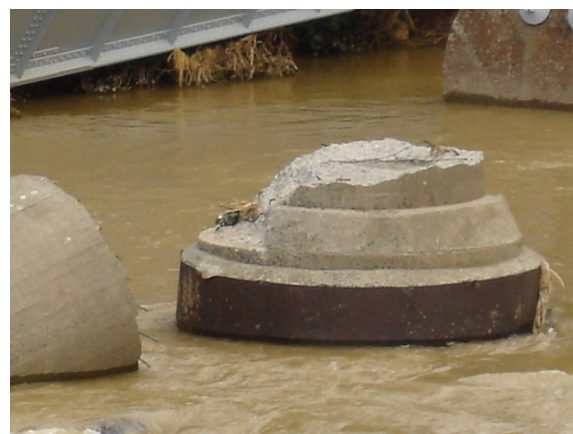
図-3 福井水害において折損した橋脚 1)
