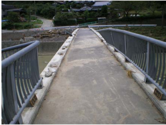
図-12 兵庫水害において変形したコンクリート桁の鋼製欄干 9)
