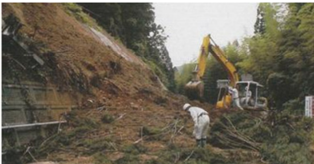
写真-2 法面崩壊による被災状況 (一)徳光鯖江線(鯖江市大正寺町) 6)
