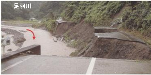
写真-1 足羽川の氾濫による道路流出 国道157号（大野市中島） 6)
