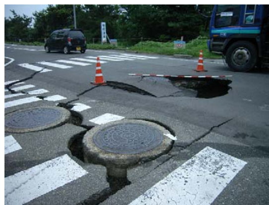
写真-1 液状化による道路陥没被害
