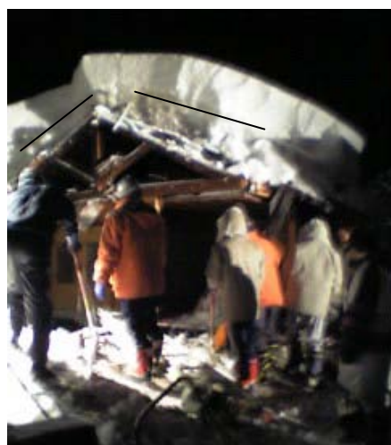
写真4 倒壊時の積雪状況と被害
