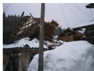
写真1 倒壊風景(右前より)
