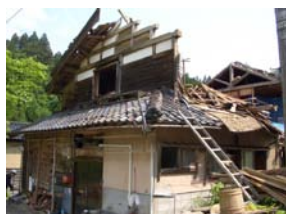
写真2 解雪時の被害状況
