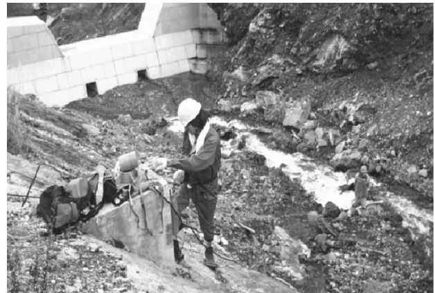
図-4 蒲原沢における水位センサ型土石流警報装置の設置
