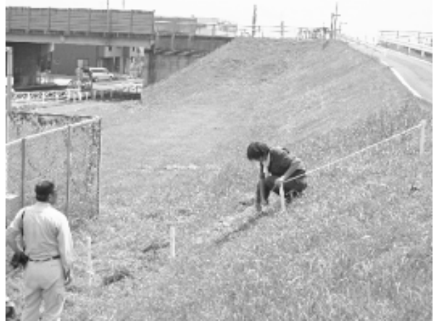
図-8 渡良瀬川河川堤防への加速度センサ設置の様子
