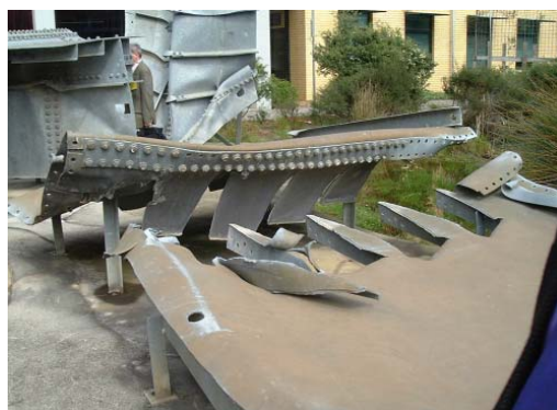
写真-3 落橋した桁の上フランジ
