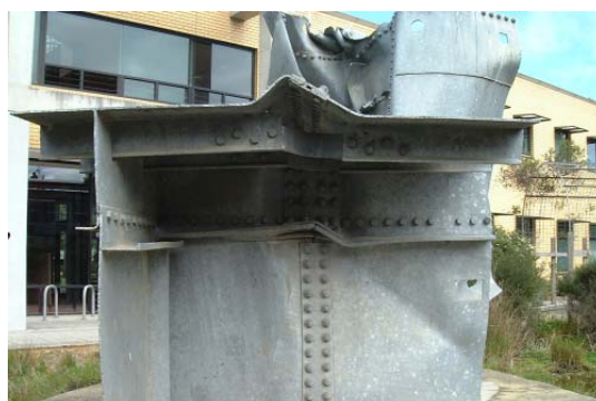
写真-4 落橋した桁の座屈状況
