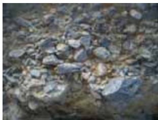
写真4 コンクリート表面
