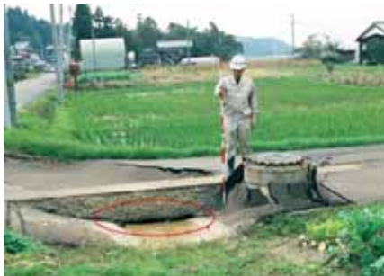
写真1 下水管の埋め戻し土の液状化による隙間の形成
