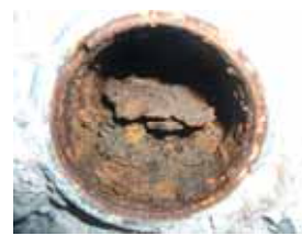
写真 6 内部管のサビ状況
