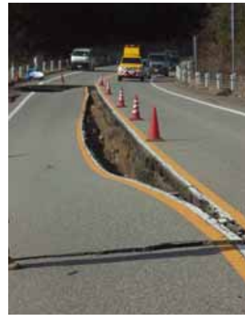
写真 - 2 2007年能登半島地震における路面段差
