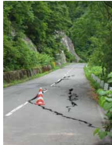
写真 - 3 2008年岩手・宮城内陸地震における路面亀裂
