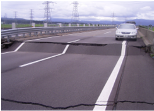
写真 - 1 2004年新潟県中越地震における路面段差 1)
