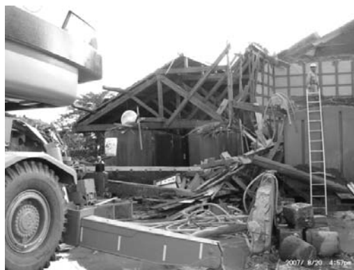
写真-1 倒壊した西蔵から貯蔵タンクの救出状況 (2007年8月20日撮影)
