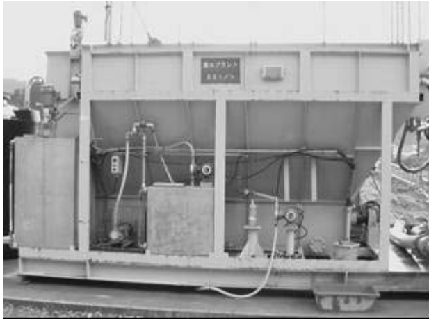
写真-2 濁水の浄化装置
