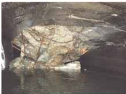
写真-1 崩落地点の状況 1) (上流側より撮影)
