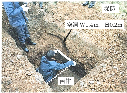
写真-6 パイピング跡の開削調査
