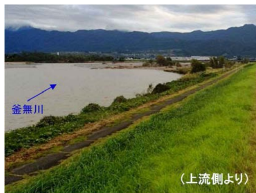
図-9 令和元年洪水による被災状況 (K-118付近右岸側)
