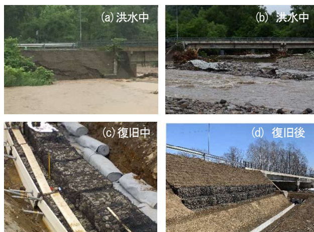
図-11 平成30年洪水の被災状況と対策工写真
