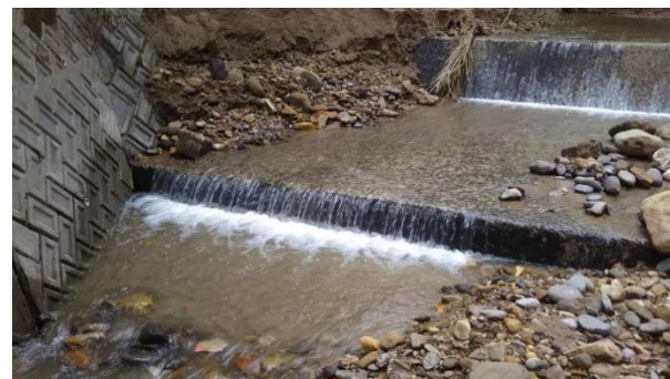
図-7 台風19号2週間後の土砂堆積による段差解消状況（令和元年10月25日撮影）
