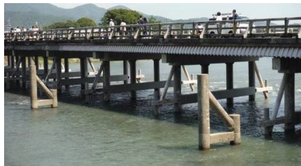
写真-1 木除杭の設置状況（京都嵐山；渡月橋）
