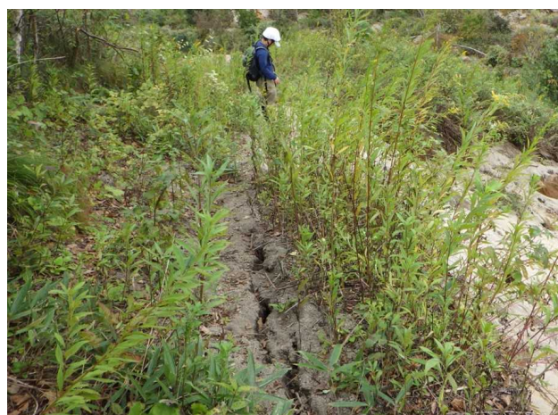
写真-2 東和川稜線付近のひび割れ状況
