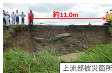
図-1 被災状況(筑後川, 2015年8月)
