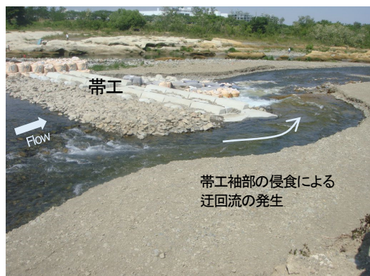
図-1 帯工袖部の侵食状況
