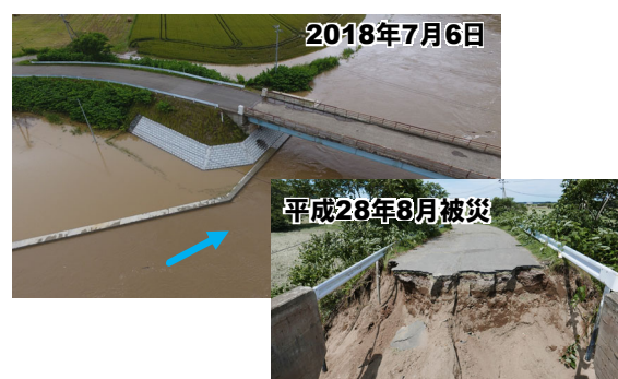
図-16 常呂川での橋台背面盛土の対策効果
