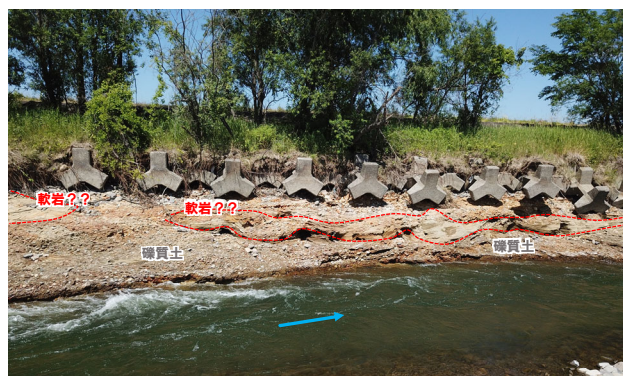
図-11 被災橋脚の周辺の河岸の状況（2018年8月5日撮影）
