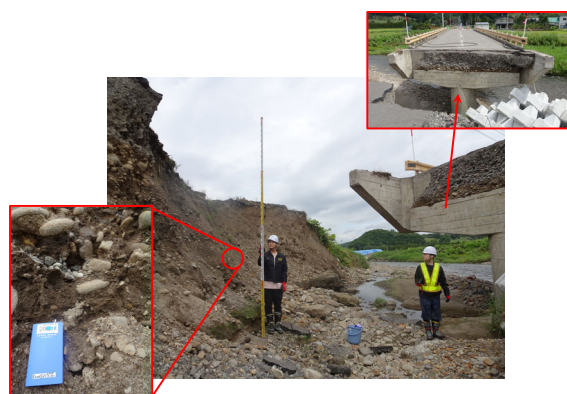
図-15 五月橋における橋台背面盛土の被災状況
