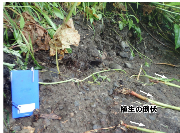
図-7 盛土のり面表層の状況
