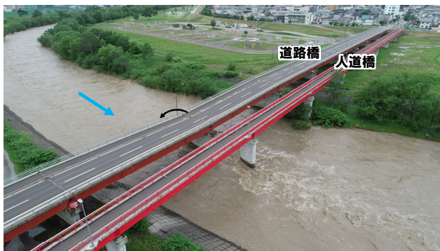
図-8 被災橋梁の全景（2018年7月4日撮影）
