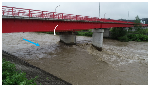
図-9 被災橋脚の状況（2018年7月4日撮影）
