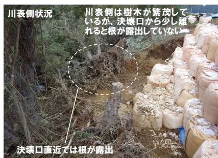
写真-1 川表側の樹木根の状況
