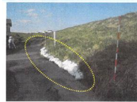
(a) 堤体漏水
