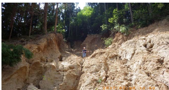
写真-2 崩壊状況（区間I）（7月30日撮影）
