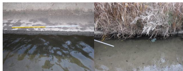
写真-6 コンクリート護岸(左)とその上部に植生が繁茂したコンクリート護岸(右)
