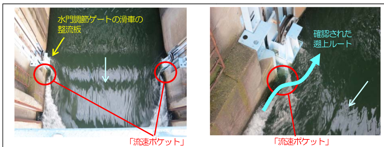
図-4 毛馬水門の越流箇所の状況
