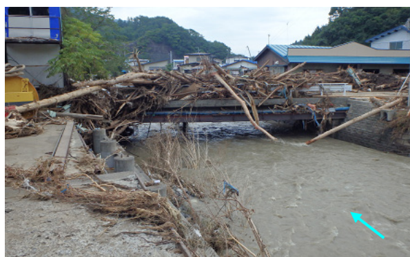
(a) 橋梁の流木被害状況
