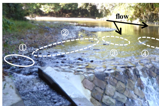
図-13 土砂流入防止対策（洪水後）
