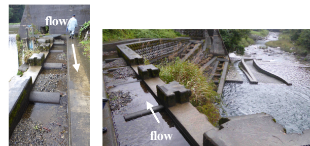
図-15 魚道の堆砂状況（堰内砂防堰堤）
