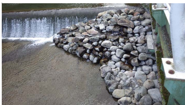
写真-24 越流水深5cm前後の流況その1 (2017.12.27記録)
