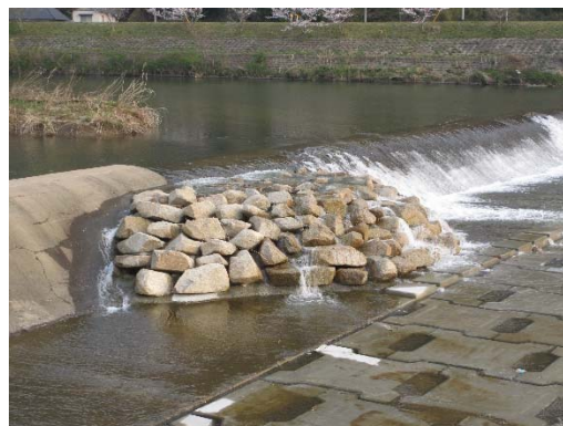
写真-26 越流水深10cm前後の右岸側の流況 (2018.4.1記録)
