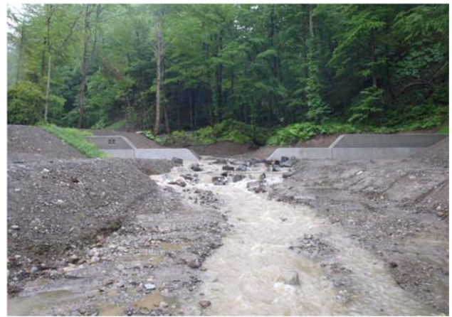
写真-10 施工後1年目の出水直後の状態 (8月)
