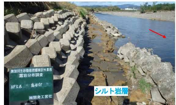
写真-2 護岸の被災と露出した軟岩（シルト岩層、KP5.8付近）
