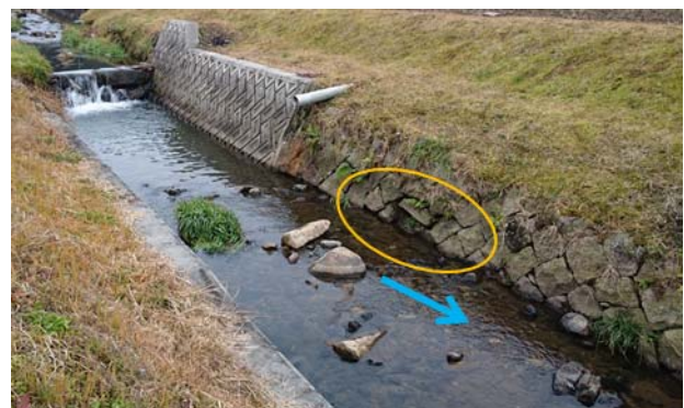
写真-1 落差工下流での被災状況
