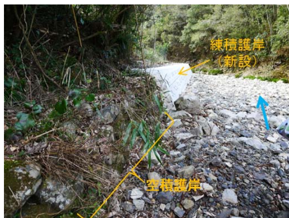
写真-2 落差工下流での被災状況
