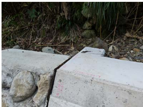
写真-3 練積護岸端部の巻き込み状況
